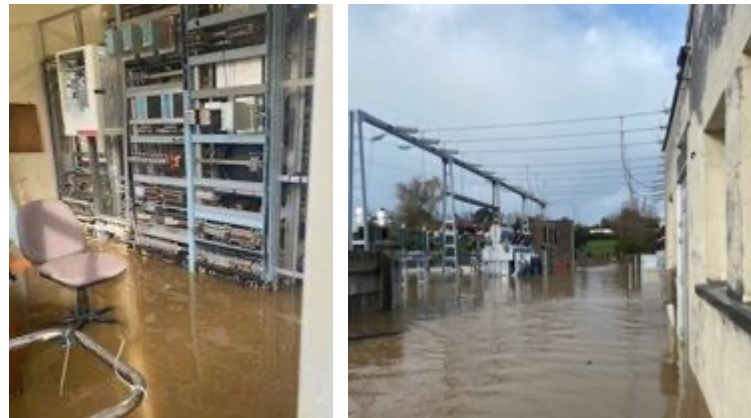
Poste 90kV de Lumbres (Nord) inondé le 6/11/2023
